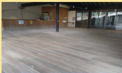
ワイン直売所で新たな体験プログラム(季節のフルーツを使ったクレープ作り体験)を販売するための床改修(土間をフローリングに)
